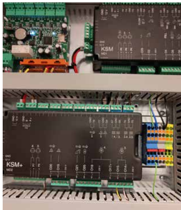
Elettrica, domotica e progettazione al vostro servizio
